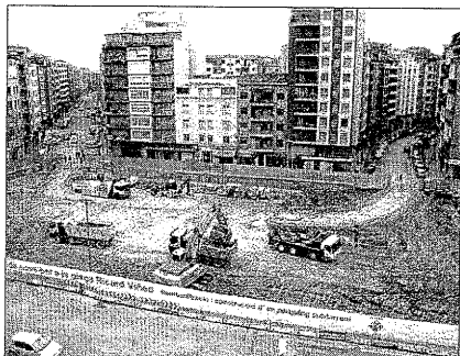
30/01/2009 Excavació. Aquesta imatge correspon a la fase inicial dels treballs d'excavació del terreny per construir l'aparcament subterrani.
