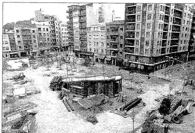
01/04/2010 Arbratge. Al març i l'abril s'hi van plantar un centenar d'arbres i va començar la instal·lació de diversos elements del mobiliari urbà, com els fanals dissenyats per Benedetta Tagliabue.
